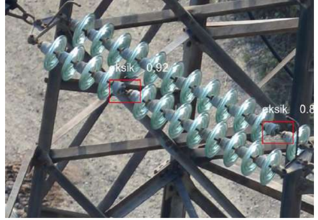
Şekil 7 İzolatörde eksik parça arızası
