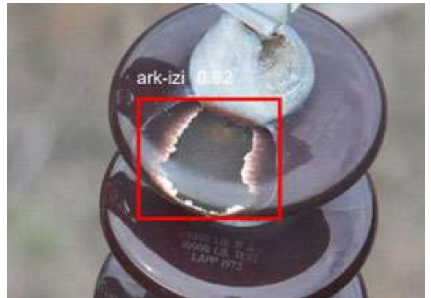
Şekil 9 İzolatörde ark izi arızası
