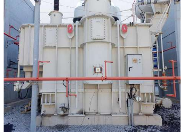
Şekil 9. 260 MVA 400/22 kV tek fazlı güç trafosu
