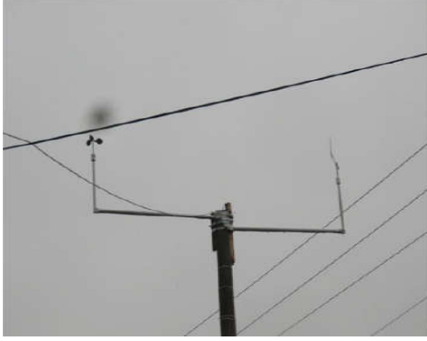
Şekil 2. Tesis edilen hava gözlem istasyonu
