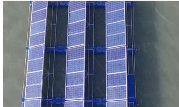
Şekil 10. Büyükçekmece Yüzer GES Projesi – 90 kW (Meteo Firması-Panel Yerleşimi)
