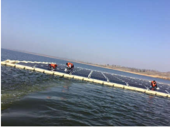
Şekil 11. Büyükçekmece Yüzer GES Projesi – 120 kW (TYT Firması)
